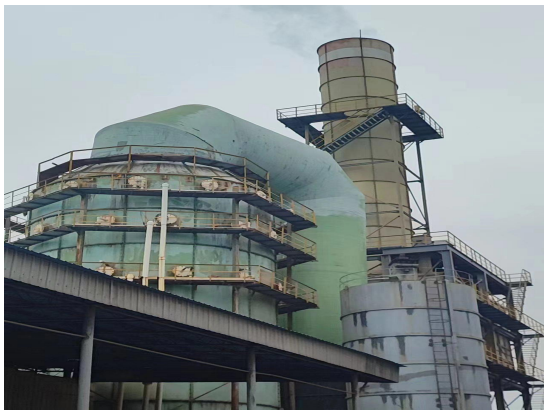
窑烟废气处理措施以及排气筒
