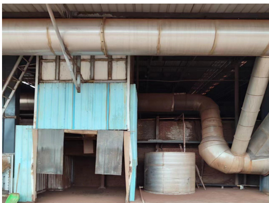
污泥烘干线收集管道
