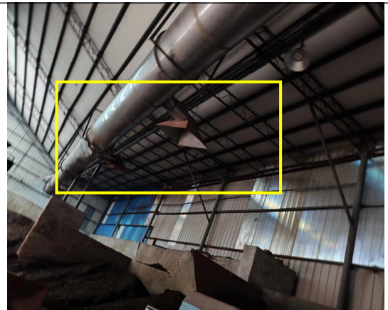
市政污泥密闭贮存间以及收集管道
