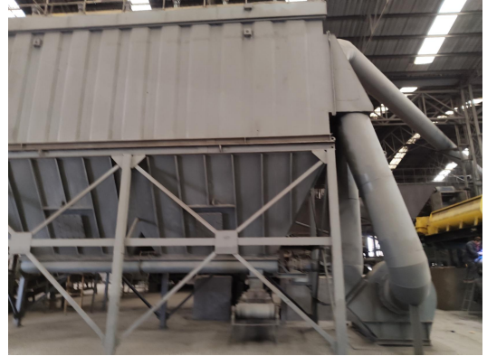
煤矸石破碎、筛分废气处理装置
