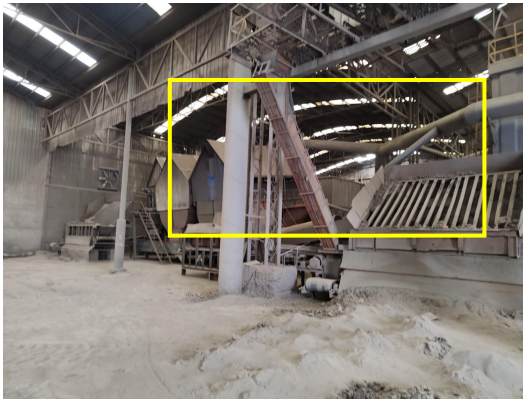
煤矸石破碎、筛分收集管道
